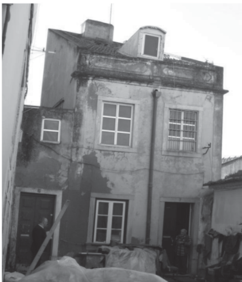
Imagem 3 - Vista da Fachada Principal do nº 6 e 7 Edifício do Largo dos Trigueiros
