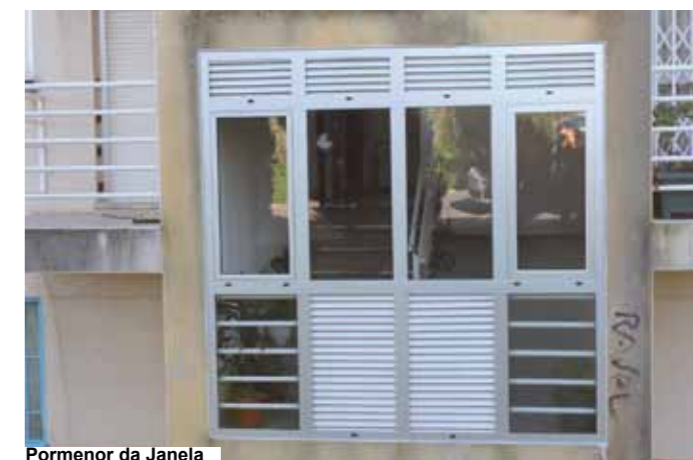
Pormenor da Janela
